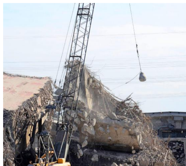
Vier Tonnen wiegt die Abrissbirne, die hier zur Zerkleinerung der mächtigen Brücke eingesetzt wird. Fotos: Christian Gleichauf
